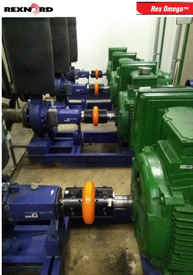
acoplamentos Rex Ômega instalados nas bombas
